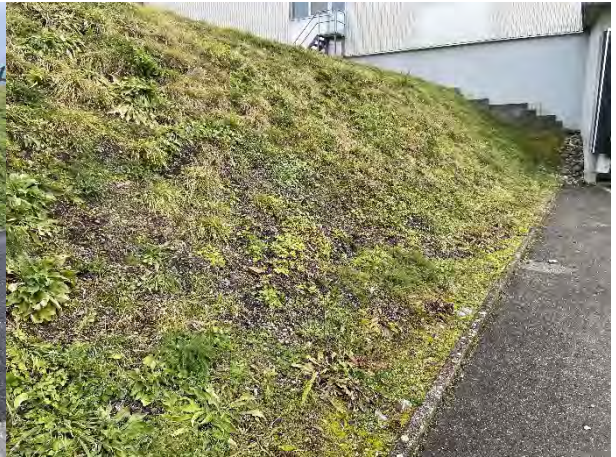
Kein Boden, viele Fremdstoffe an Böschung bei Rampe
