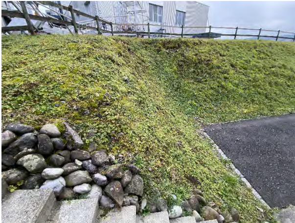
Kein gewachsener Boden an Böschung bei Kläranlage
