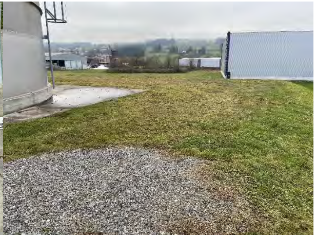
Kein gewachsener Boden auf Aufschüttung bei Kläranlage
