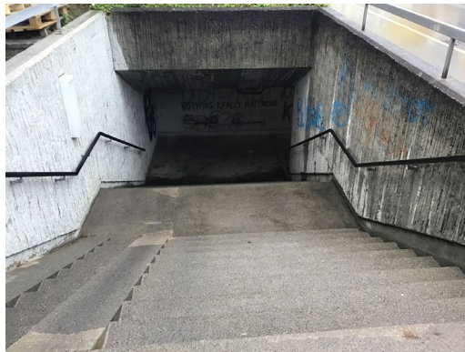
Abbildung 14: Steile Treppen / Rampen verhindern, dass Unterführung für alle zugänglich ist, Aufnahme Oktober 2022
