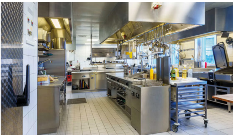
Insbesondere die Küche des Restaurants Braui soll erneuert werden. Für den Herd sind keine Ersatzteile mehr erhältlich.
