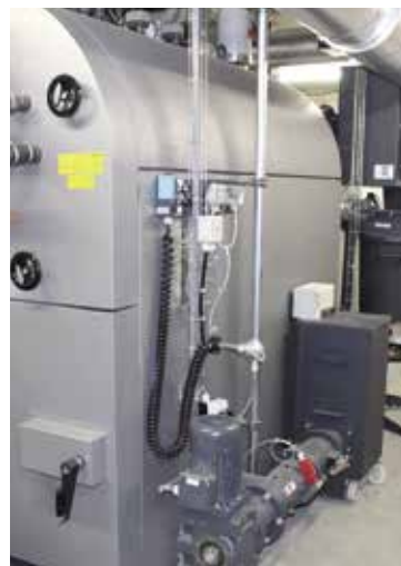
Neue Heizungsanlage Kulturzentrum Braui.
